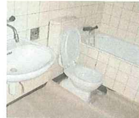
une installation sanitaire
